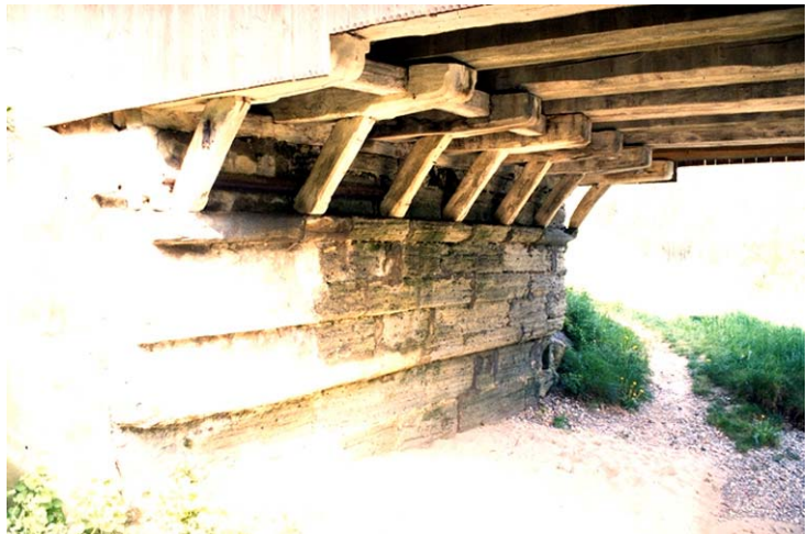
Ansicht des westlichen Widerlagers. Die Gesteinsoberfläche zeigt bereits deutliche Spuren der Verwitterung. Abb. 2 (GS, 9. 5. 2001)
